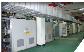
▲ Chlor-Alkali 제조공장 전원장치
